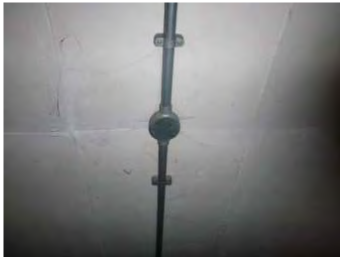
Metal Electrical Conduit
