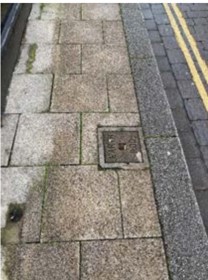
9. Earth rod chamber
