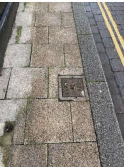
9. Earth rod chamber
