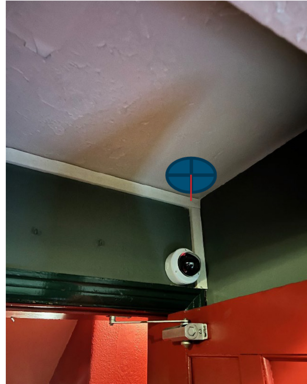
AP 16 - Foyer Box Corridor
