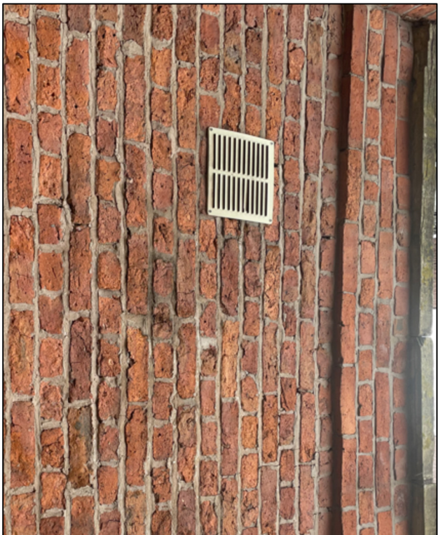
4) Air vent grill
