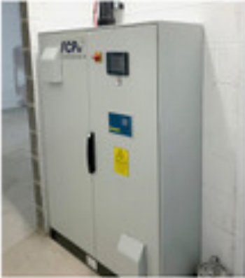
1 Fan Control Panel
