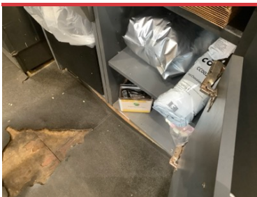
DOOR MISSING PLINTH BLOWN
