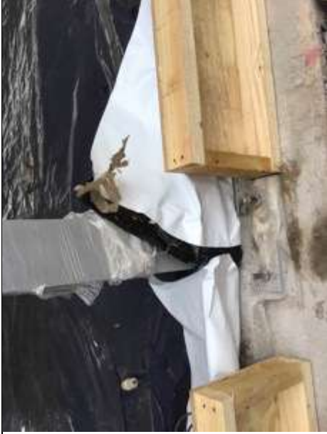
Damage to perimeter edge
