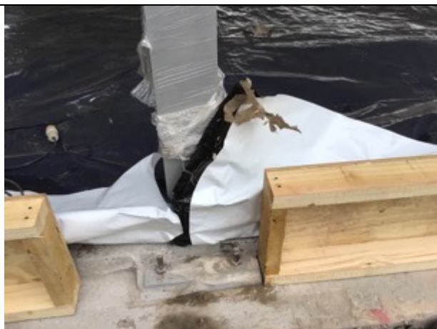
Damage to perimeter edge
